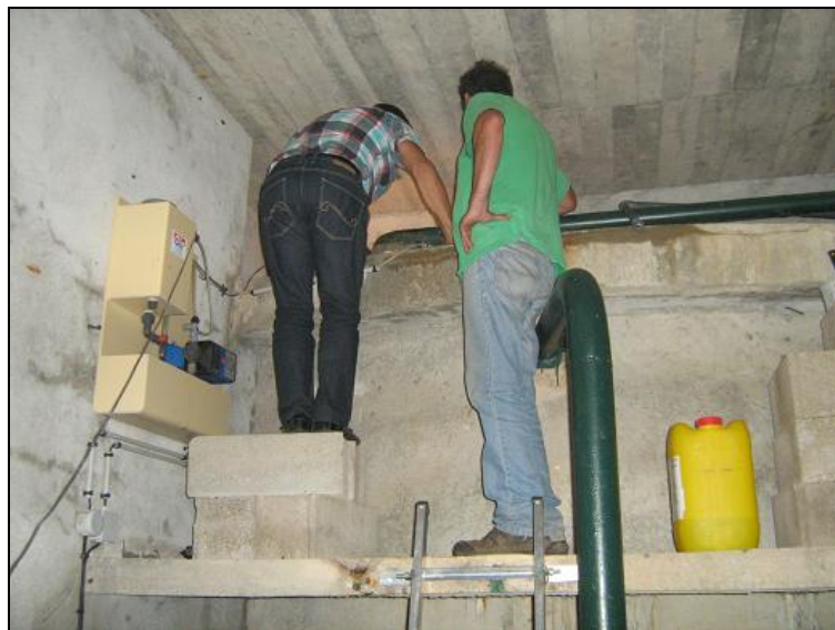
Figure 8 – Réservoir de Bions avec traitement à l'eau de javel desservie par une pompe péristaltique
