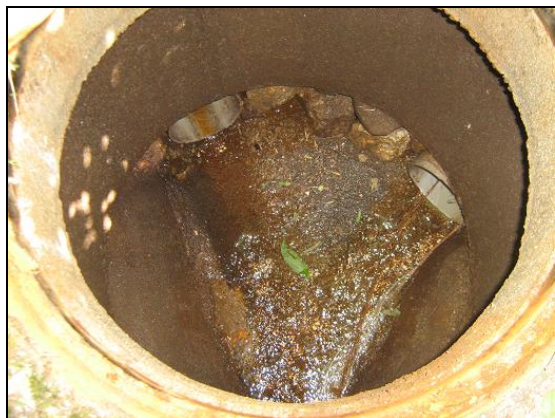
Figure 7 – Regard de collecte général situé en bord de route recevant les eaux de Fontalard, de l'Adret de Grimal et du Coudoulous
