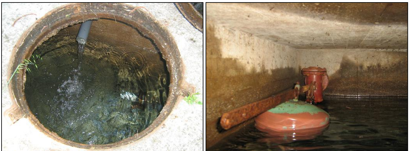
Figure 6 – Regard de collecte général situé en bord de route recevant les eaux de l'Adret de Grimal (photographie de gauche) et les eaux du Coudoulous par une vanne à flotteur (photographie de droite) (remarque : suite à l'abandon du captage du Coudoulous, il faudra veiller à ce que la conduite d'amenée de l'eau issue de ce captage abandonné soit déséquipée de façon à ce qu'aucune eau parasite de quelque provenance que ce soit ne puisse parvenir dans le réseau d'eau destinée à la consommation humaine)
